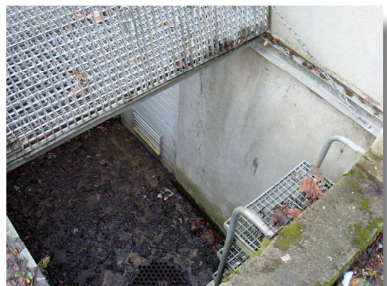
Einstieg zu bestehender Transformatoren-Station
