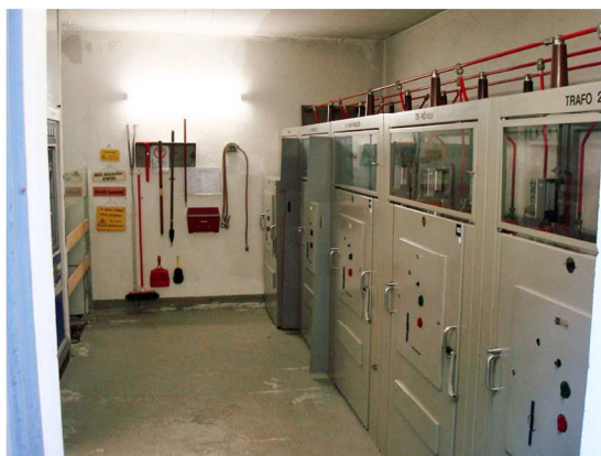
Bestehende Gebäudestation, Mittelspannungsanlage mit offenen Sammelschienen
