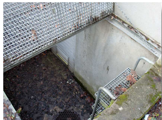
Accesso alla cabina di trasformazione esistente.
