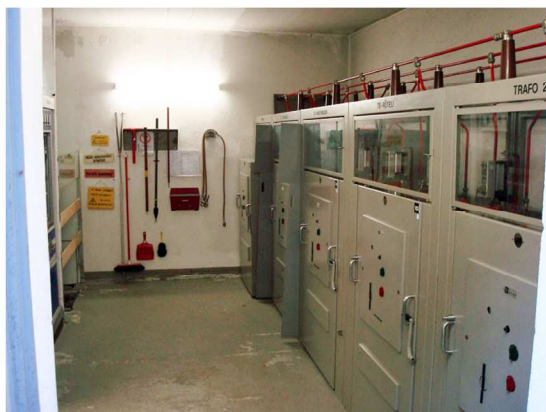
Cabina prefabbricata esistente, impianto a media tensione con sbarre collettrici aperte.
