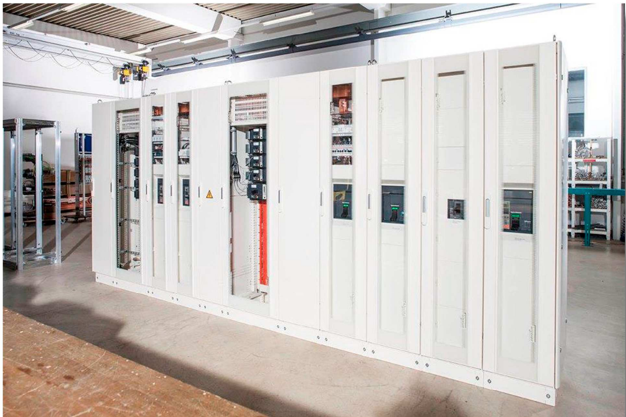
Schneider Prisma Plus - Schrankverteilung vor der Auslieferung
