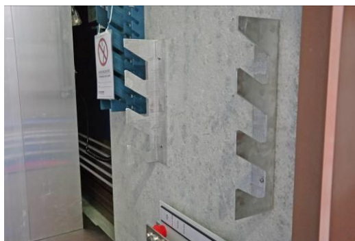
Les deux supports de fusibles sont montés et les fusibles HT peuvent être insérés.
